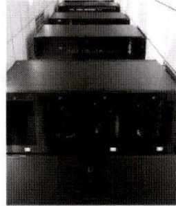
รูป NT Data Center ที่นนทบุรี
